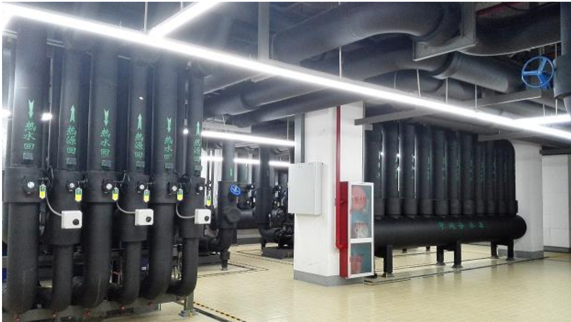
项目现场 空调机房
