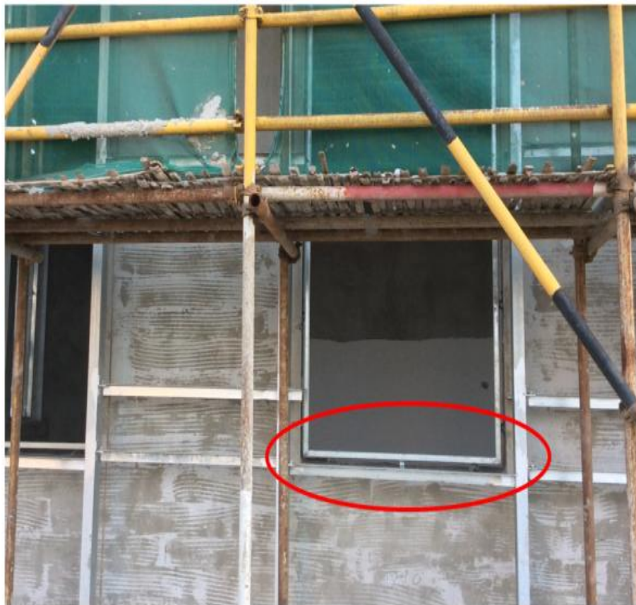
a) 附框与墙体缝隙偏大
