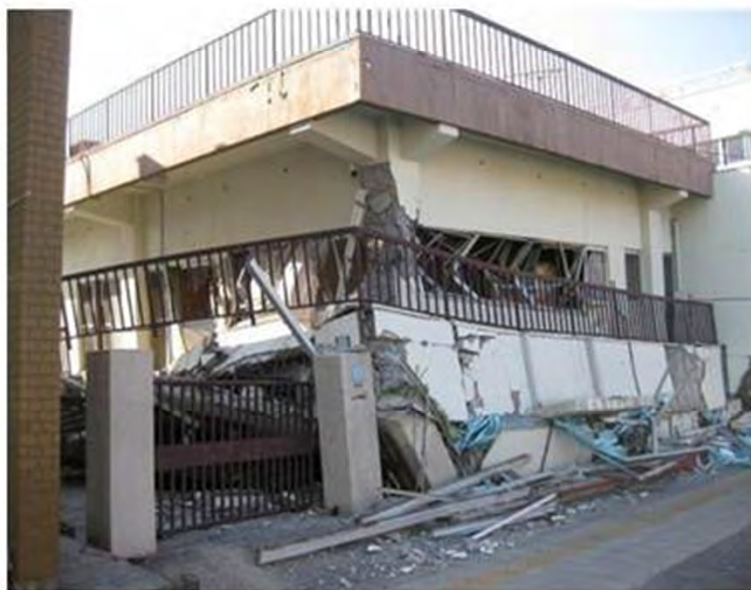
毁坏的低层钢筋混凝土建筑（仙台）
