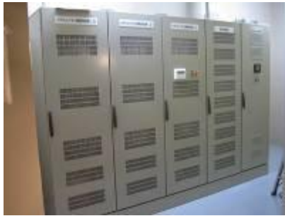
用于测试的蓄电系统 (50kWh)
